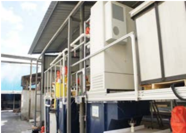
含砷废水深度处理示范平台
